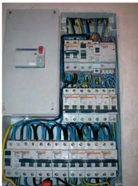
Cuadro eléctrico situado en un lugar peligroso debido a elevado nivel de humedad
